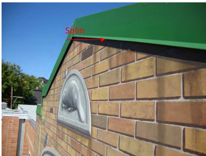
Détail de la fresque L'hôtel des voyageurs , de Serge Malenfant, du groupe Murales urbaines à revitalisation d'immeubles et de réconciliation sociale (M.U.R.I.R.S.) , montrant un solin qui empêche l'eau de s'infiltrer dans le mur. (page consultée le 24 avril 2013)
