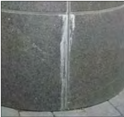
Efflorescences provoquées par une application d'un mortier inapproprié et/ou par infiltration d'eau.
