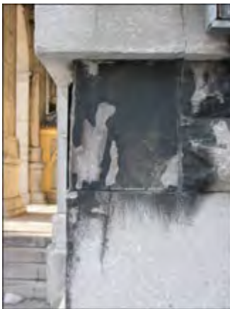
Croûte noire de sulfate de calcium et desquamation de la pierre sur une zone abritée de la pluie.
