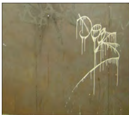
Graffiti sur un support en acier Corten. Fantôme d'un ancien graffiti visible au coin supérieur gauche.
