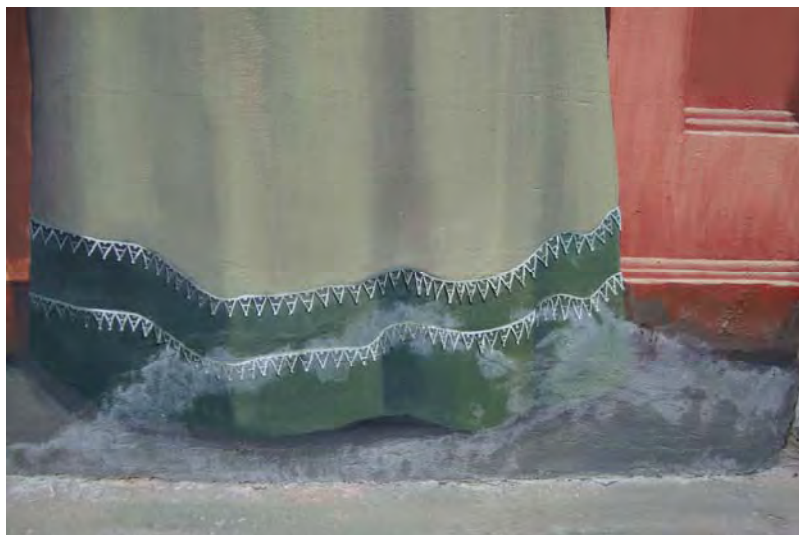
Détail de la Murale du bicentenaire de Sherbrooke , du groupe M.U.R.I.R.S. montrant des efflorescences blanchâtres résultant de sels déposés sur la surface du mur; elles sont causées par la migration de l'eau et de la vapeur d'eau entraînant des sels de déglacage.
